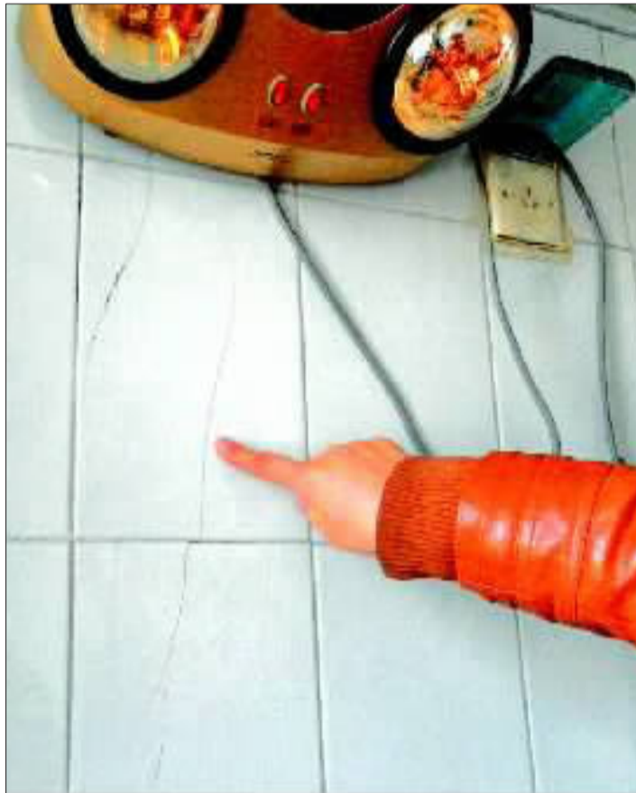
居民楼墙面上现长长裂痕。
