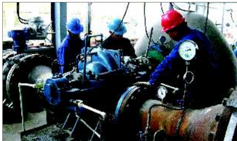
东郊热电厂工作人员在高温水首站检修设备。本报记者 刘守善 摄 (资料片)
