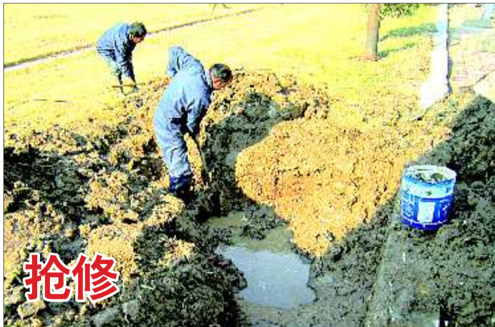
23日11时许, 西城辛兴小区外围的供水管道破裂, 11时10分供水公司工作人员对破裂的管道进行抢修。经过4个多小时的连续工作, 下午4时管道恢复供水。 本报见习记者 顾松 本报通讯员 胡存立 摄影报道
