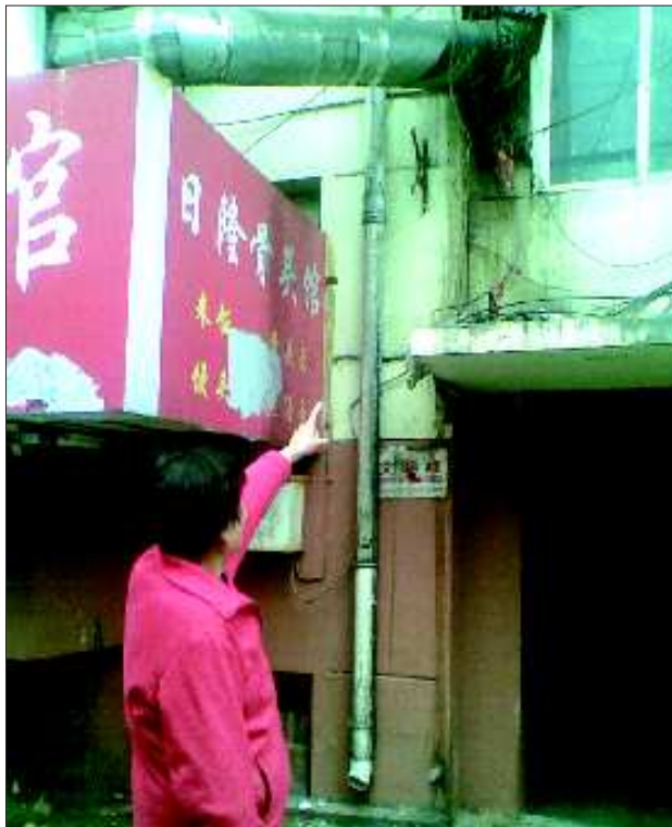
烟台市市府小区内一居民向记者指示一餐馆烟囱大面积漏油。记者 任鹏 见习记者 李娟娟 摄
