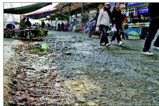
路面坑洼不平。
