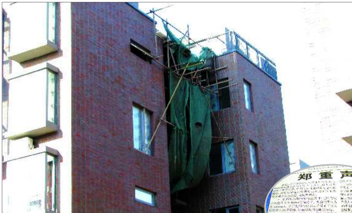
▲小区6号楼外墙上搭着的脚手架让人捏了一把汗。
