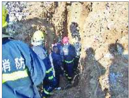
消防人员正在营救被埋者。
