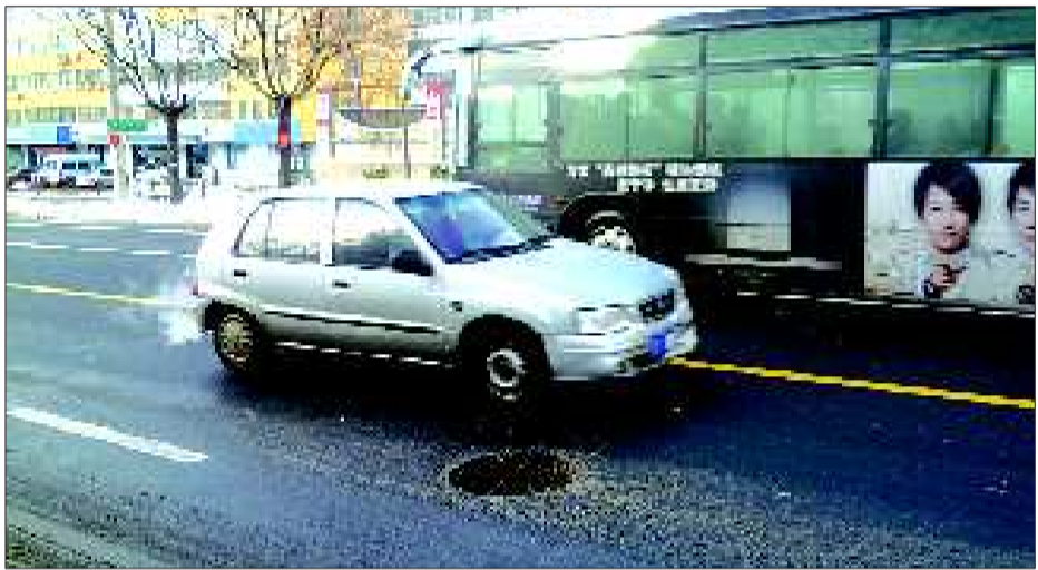
“陷阱” 3日早晨,在烟台芝罘区凤阳街烟台四中附近,记者看到马路中央一井盖丢失,周围却没有任何安全标志,存在安全隐患。在路旁的大爷告诉记者,那个井盖已经消失有两三天了。实习生 王红平 摄
