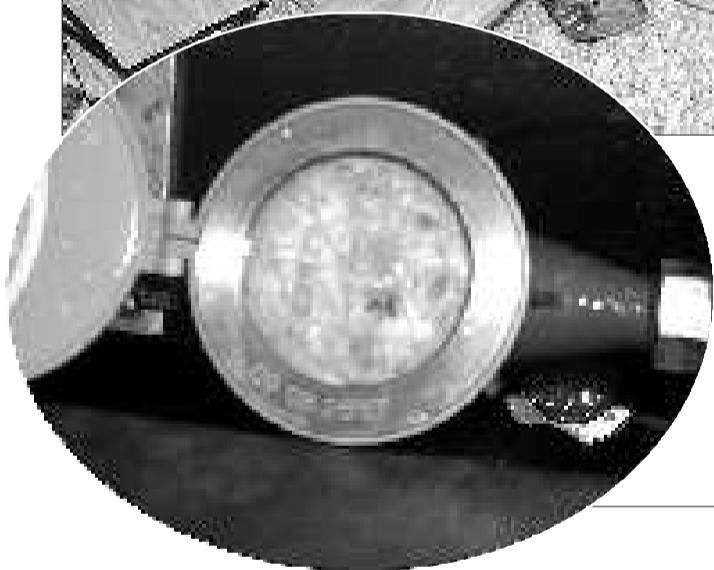
◀小区近50块水表玻璃盖被冻裂,成“玻璃花”了。
