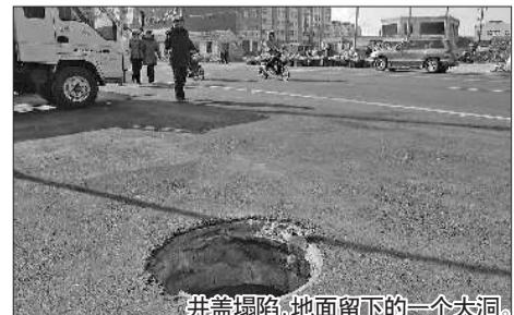
井盖塌陷,地面留下的一个大洞。
