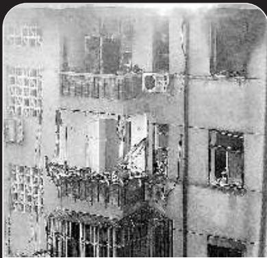
居民楼的好几个阳台被烧坏。王媛 摄
