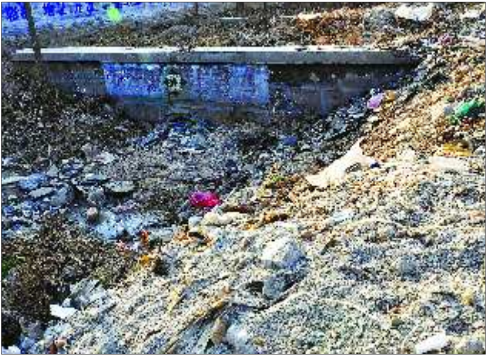
建筑垃圾已经把桥洞完全堵上了,排水渠快被填平了。 本报记者 苏超 摄
