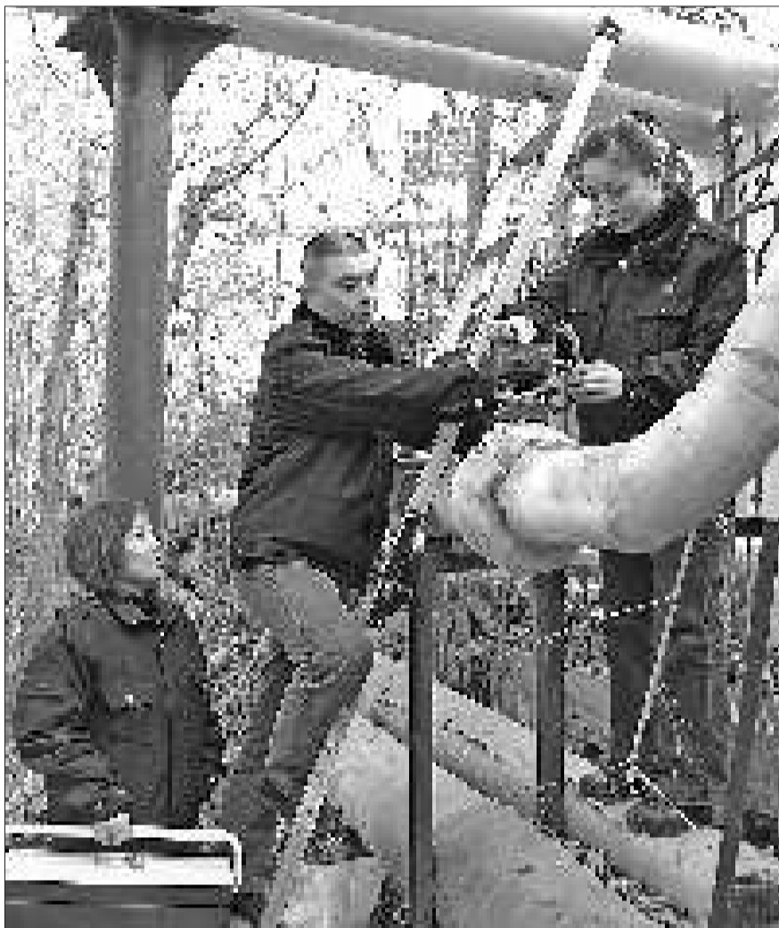
▲热力公司维修队在巡查热管网。 刘守善 摄
