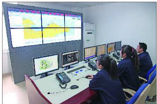
山东电信为省海洋渔业厅建设的应急救援指挥中心。
