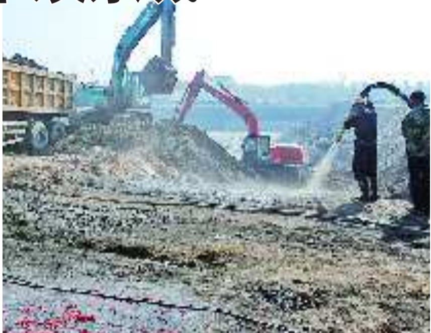
2月21日, 在海洋馆原址上, 地下娱乐城建设工地一片忙碌景象。 本报见习记者 汪振荣 姜海蛟 摄
