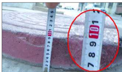
记者现场测量井盖的高度。本报见习记者 顾松 摄
