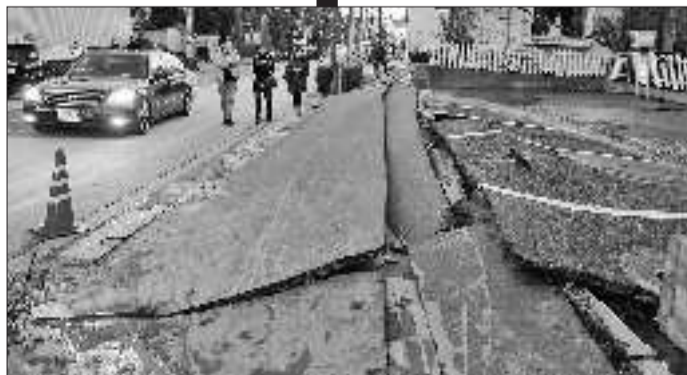
3月11日,日本千叶县的一条道路因地震变形开裂。新华社发
