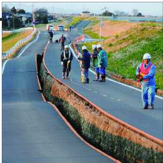
▲埼玉县，工作人员在检查一处扭曲塌陷的路段。
