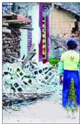
倒塌的空心砖墙。(资料片)
