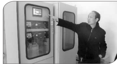
罗庄区黄山镇南涑河老屯桥自动水质监测站站长赵永志在介绍监测站情况。 本报记者 胡志英 摄
