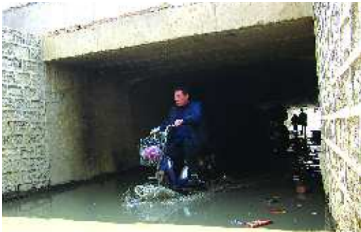
涵洞积水处,不时有市民经过。
