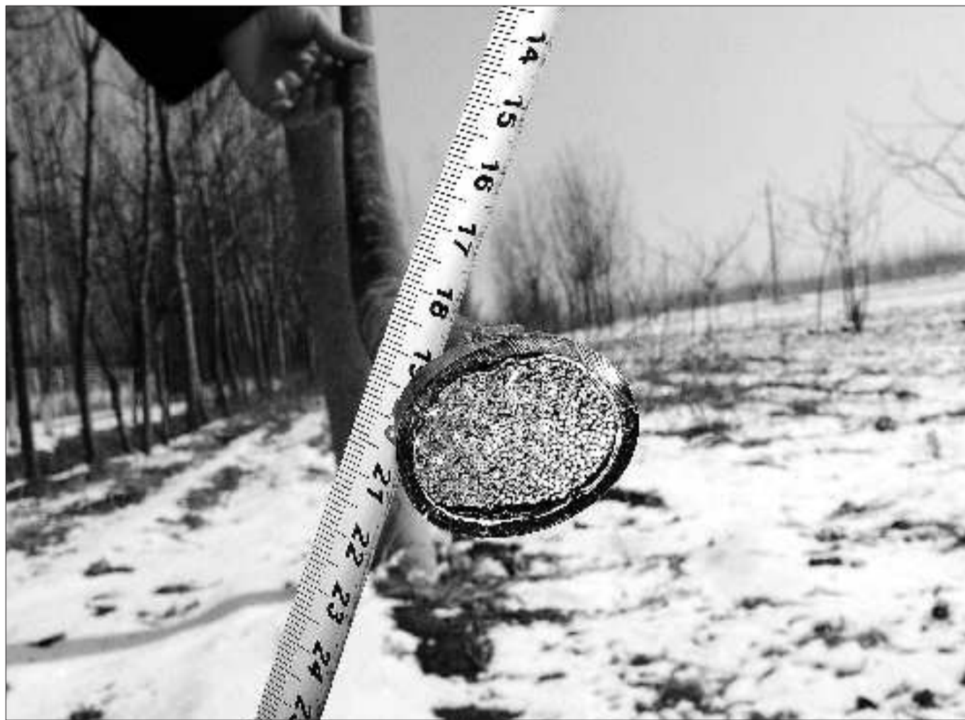
一根电缆中包含数百对线路,被割后造成的损失不可估量。
