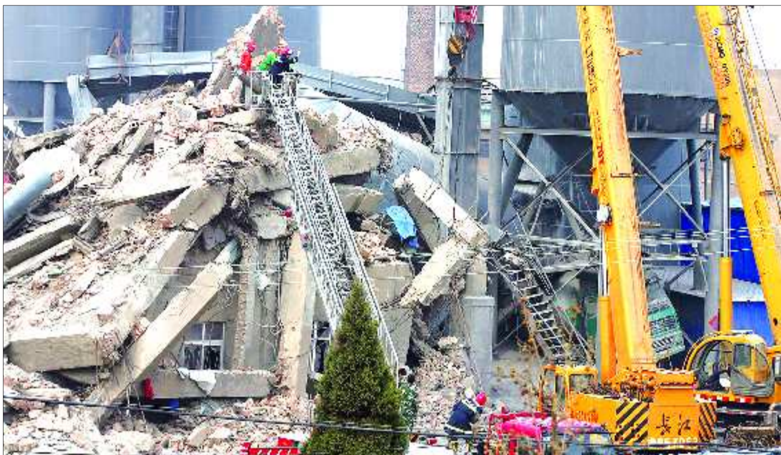
14日上午,粉末储存罐倒塌后又压塌了二层厂房,两人被埋,抢险救援车紧急救援。本报记者 杨宁 摄
