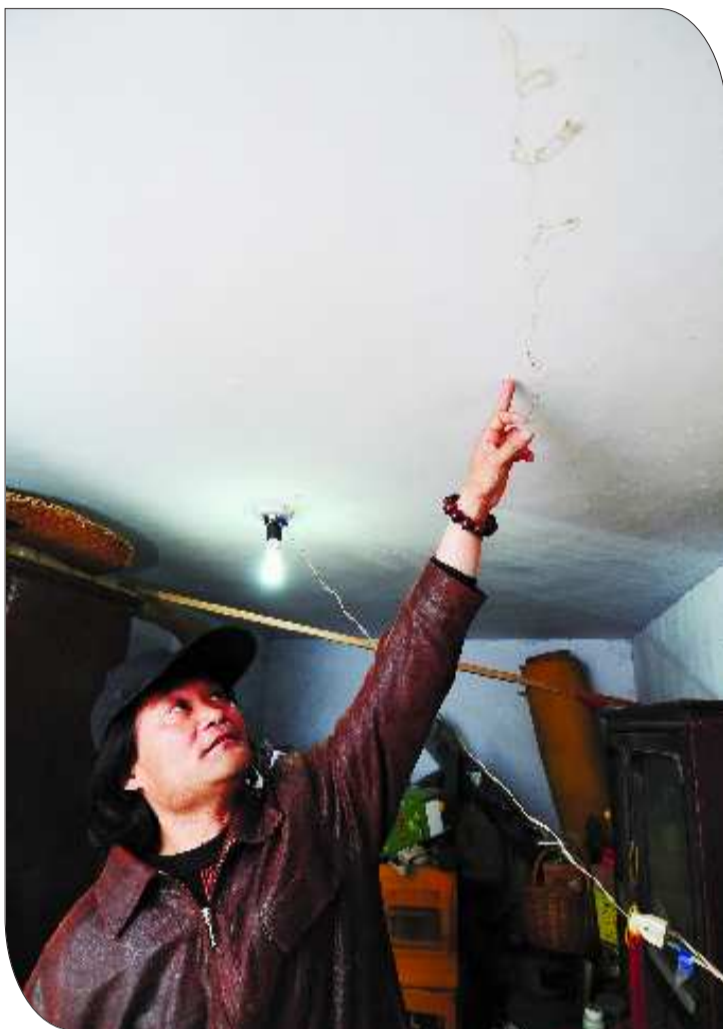
从楼下邻居储藏室看到,程文月家客厅地面的裂缝已经贯通了。
