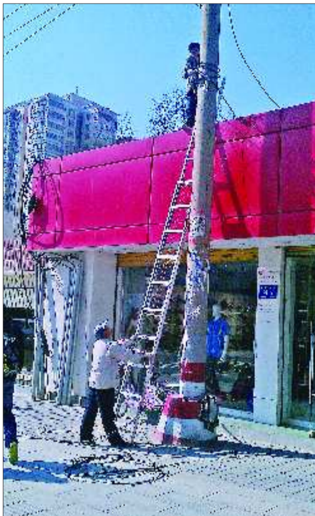
在文化东路道路北侧一家商铺前,施工人员正在拆除废旧线缆。实习生 周玉 摄
