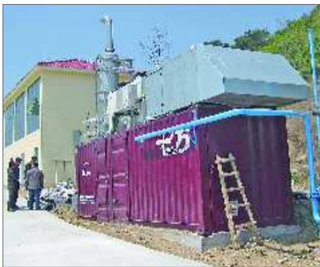
4月27日,黄山垃圾填埋场填埋区旁沼气发电设备已经安装完毕。本报记者 侯健 摄
