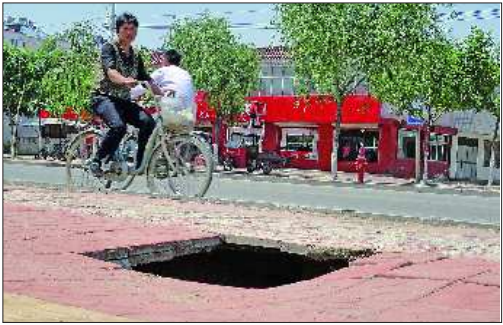
德兴北路东侧花砖路面上的大坑。 本报见习记者 孙明利 摄
