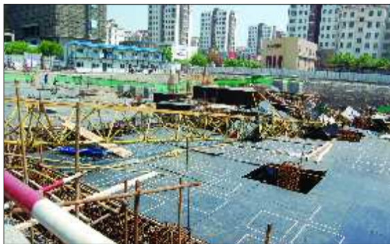
断裂的塔吊倒在脚手架上。
