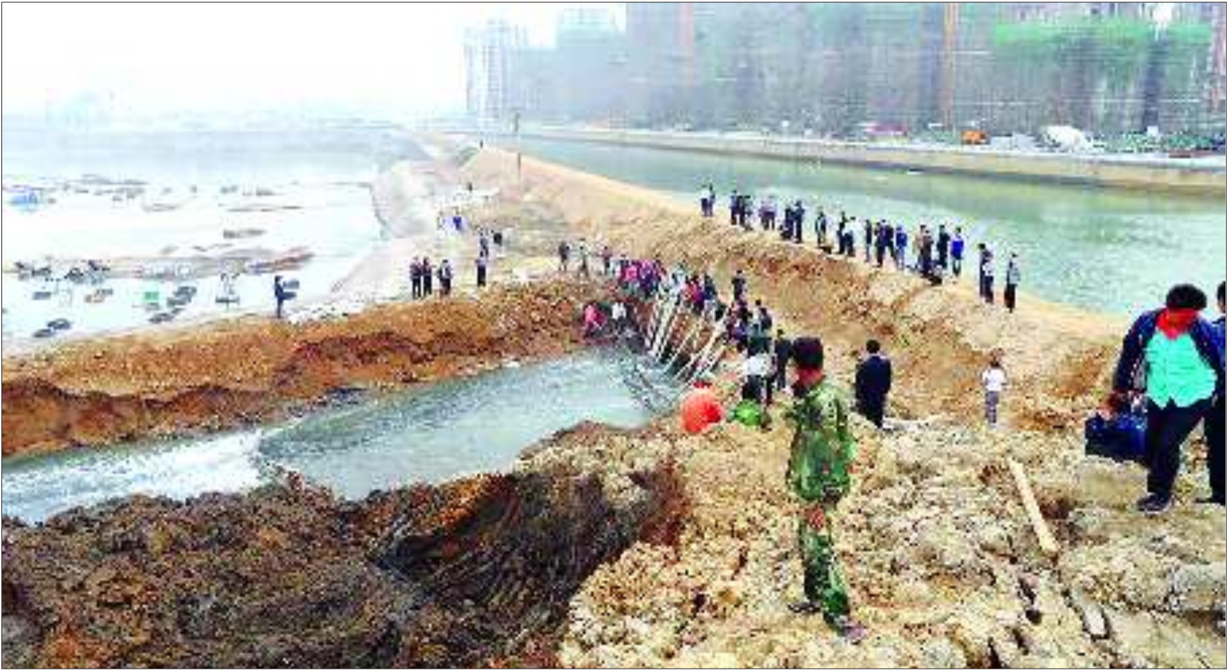
19日上午,港区(右上角水域)海水涨潮时冲破防护堤,淹没事发工地(左上角区域)后,抢险人员奋力将排水口堵住。 照片由积米崖边防派出所提供
