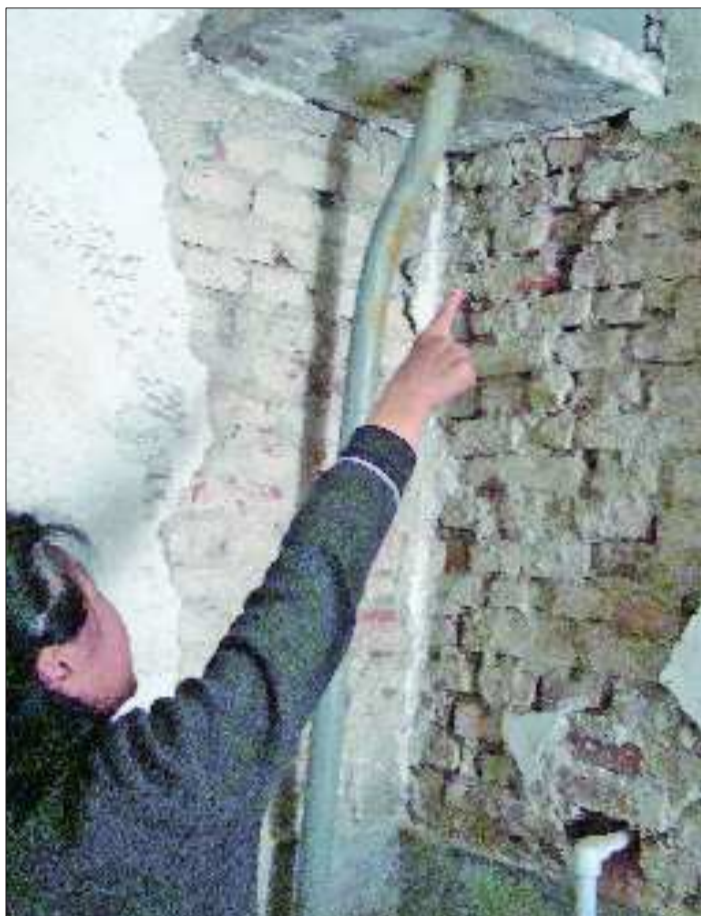
公厕开裂墙体依旧。实习生 张伟 摄
