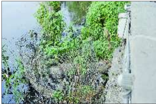
一排水口不远处,用铁栅栏拦住的地方有不少污物。
