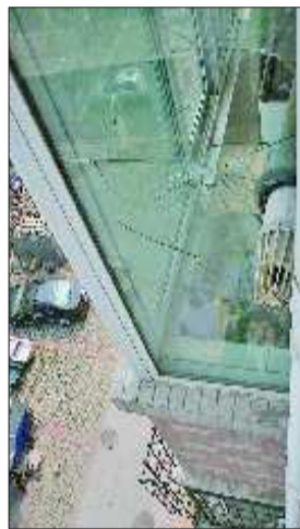
叶师傅家北阳台的玻璃窗被砸坏。本报记者 尉伟 摄
