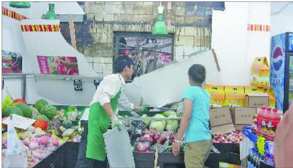
包子铺隔壁的超市内,工作人员正在清理爆炸后受损墙体的碎墙板。 本报记者 寇润涛 摄
