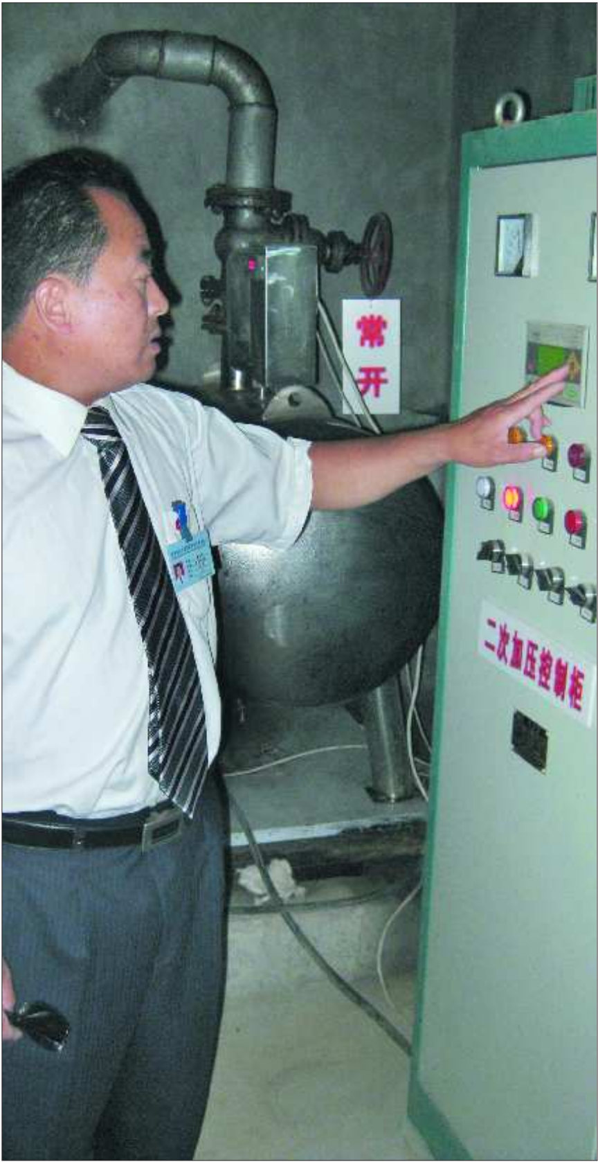
枣庄市安居物业华府管理处的工作人员在二级泵房查看并调节二次加压控制柜上的数据。 见习记者 杨霄 摄
