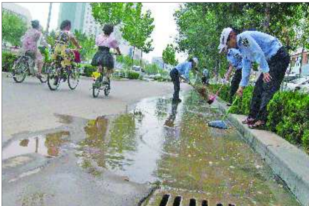
在共青团路施工现场,外溢的自来水流到了湖滨中大道上,城管执法人员正抓紧清理。 本报记者 杨金涛 摄
