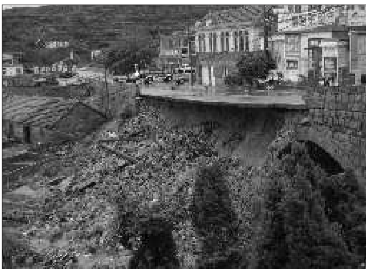
公路路基塌方现场。(图片由公路局提供)
