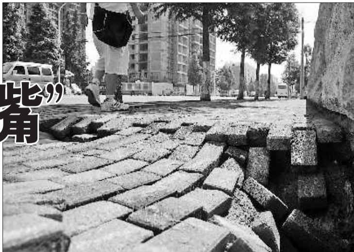
7月4日,在东港区教育局对面的人行道上,大雨导致路面塌陷,给过往行人带来不便。本报见习记者张照朋摄
