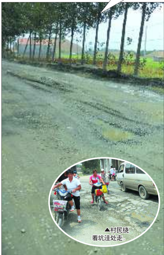
▲路面上坑坑洼洼。
