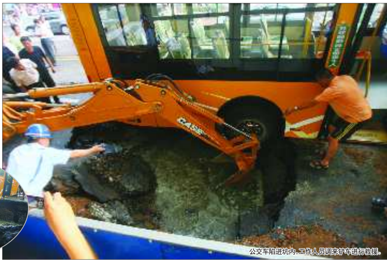
路面塌陷,正常行驶的公交车陷了进去。
