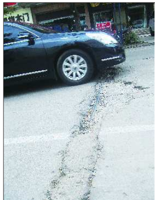
黄海三路破损的路面经常“肇事”。本报记者 彭彦伟 摄
