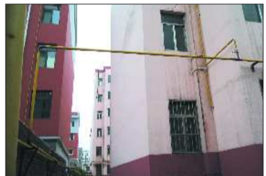
千乘小区楼体外围的燃气管道被怀疑是小偷入室行窃的工具。
