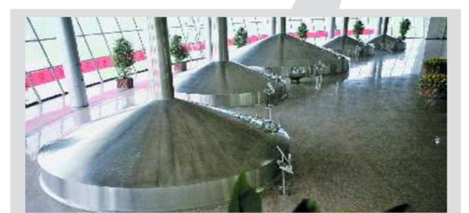
啤酒生产车间里依次排开的糖化锅、煮沸锅、发酵罐。
