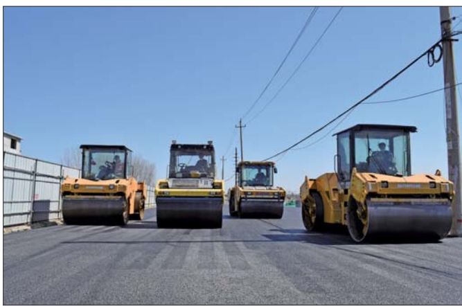
3月19日,济齐大道左半幅(南半幅)沥青下面完成层摊,实现了半幅贯通。
