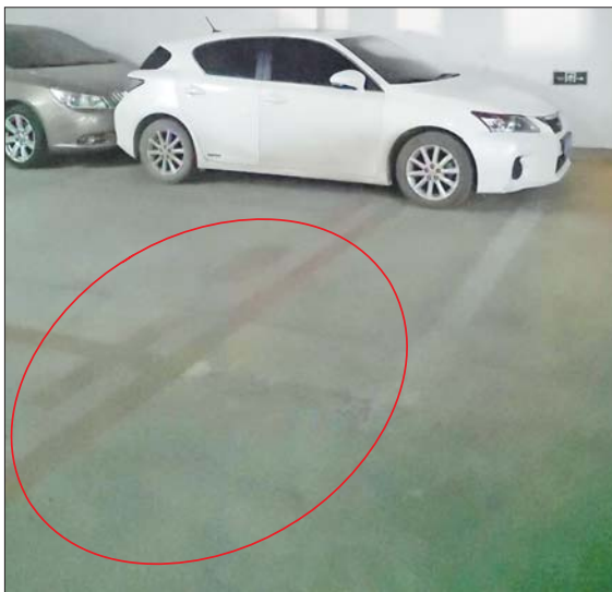
多画出来的车位线已经被抹除,但还能看出一些痕迹。
