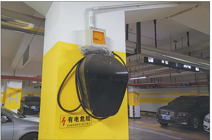
万科城小区地下车库已安装多处充电桩。
