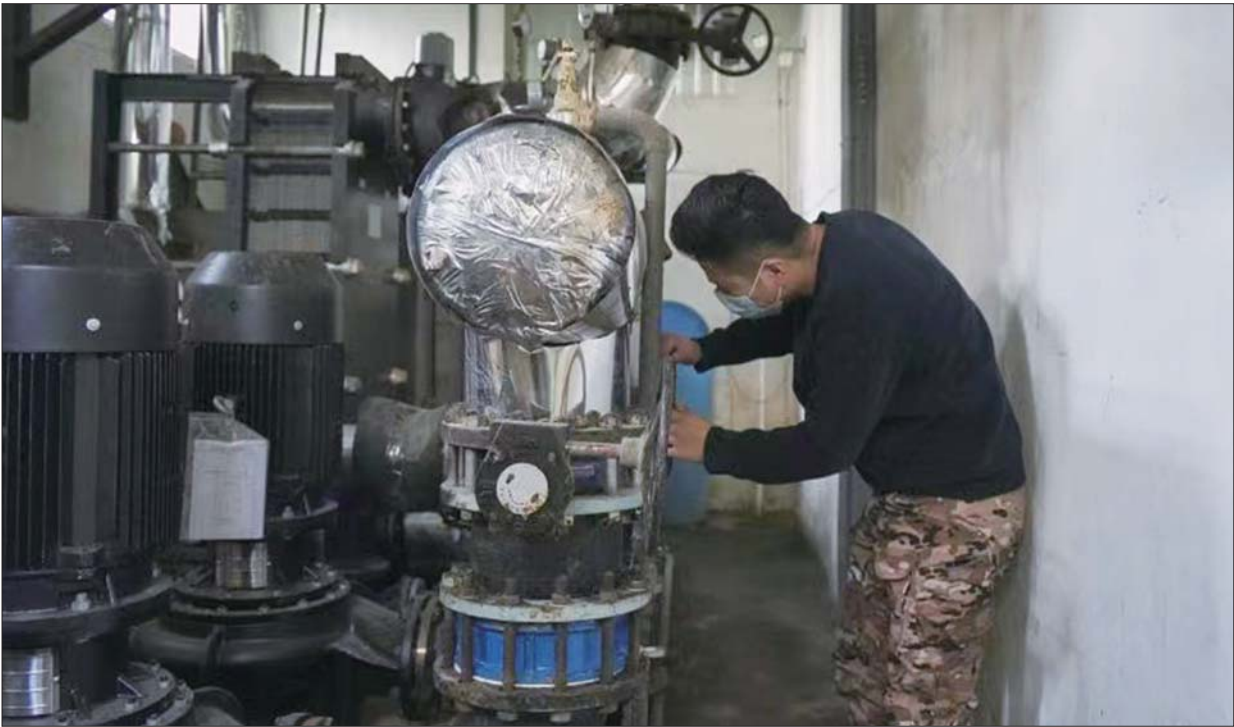
工作人员正在监控供热系统参数值和注水情况。
