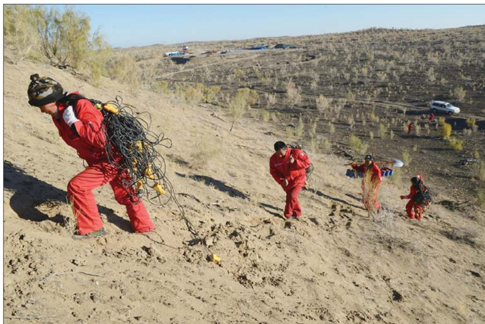
SGC2109队严格遵守当地环保要求,采取人进车不进的施工方式,保证生产的有效运行和环保工作的落实。通讯员 陈俊 摄
