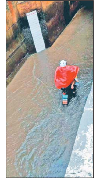
市民骑电动车涉水经过涵洞。
