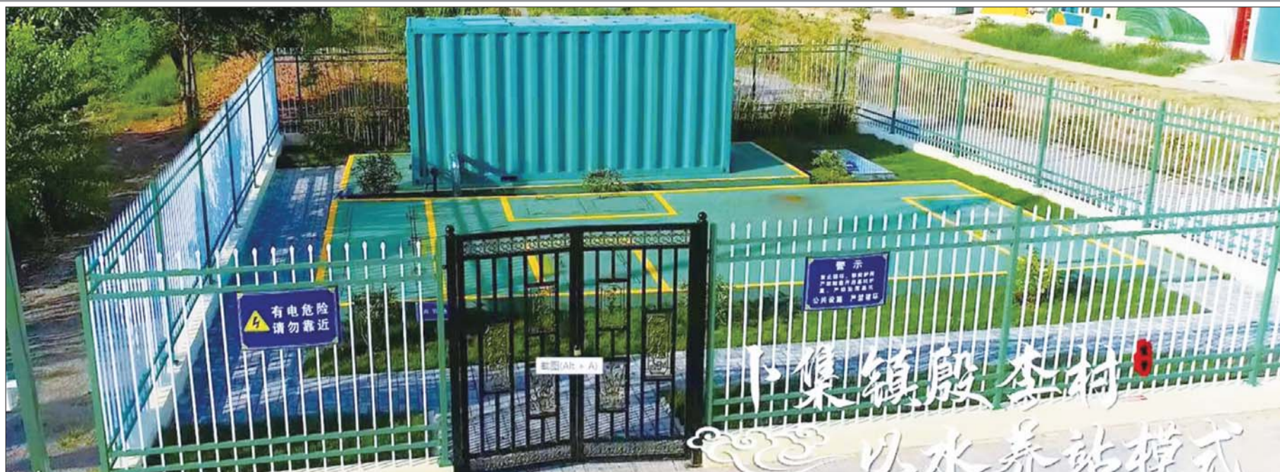
卜集镇殷李村污水处理站。
