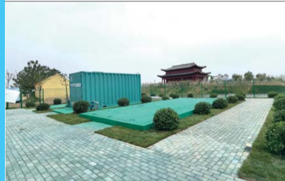
金乡县马庙镇杨官庄污水处理站。
