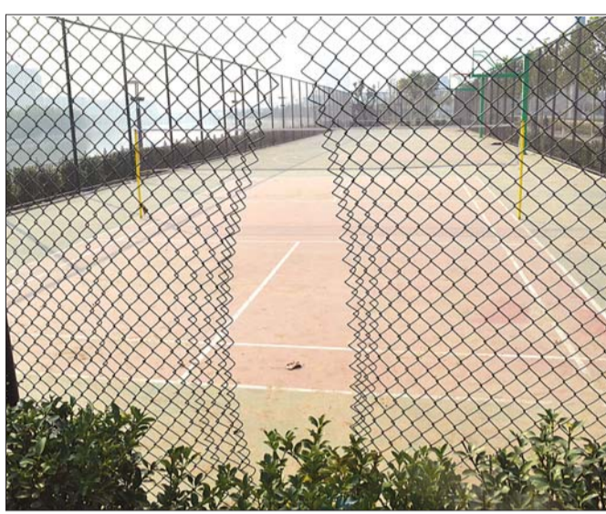
建成几个月的运动场还未投入使用,就已经被撕开了一个大口子。 本报记者 赵伟 摄
